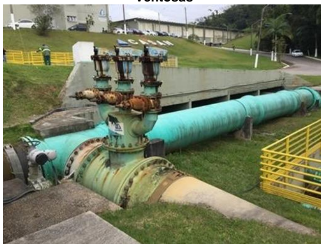
Figura 31: Adutora de 1.200 mm - Detalhe das Ventosas
