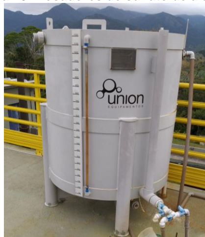
Figura 18: Dosadores de sulfato de alumínio
