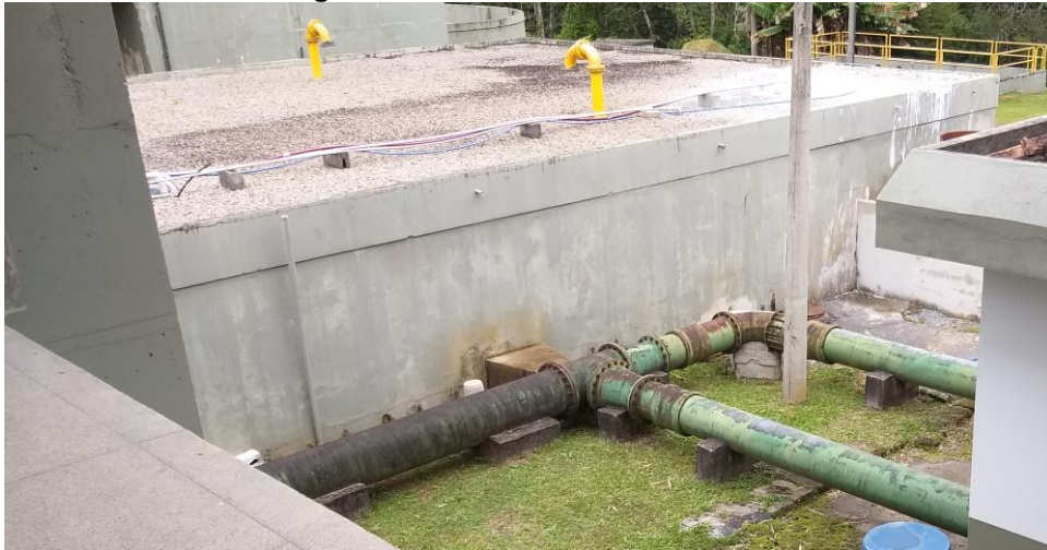
Figura 24: Reservatório de Contato
