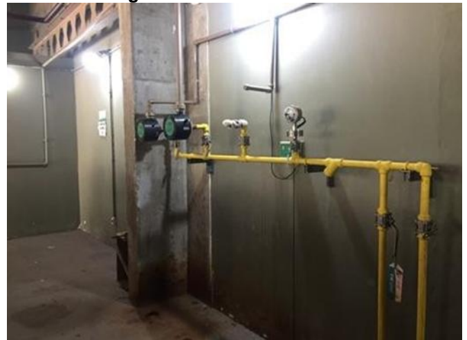
Figura 26: Dosador de cloro
