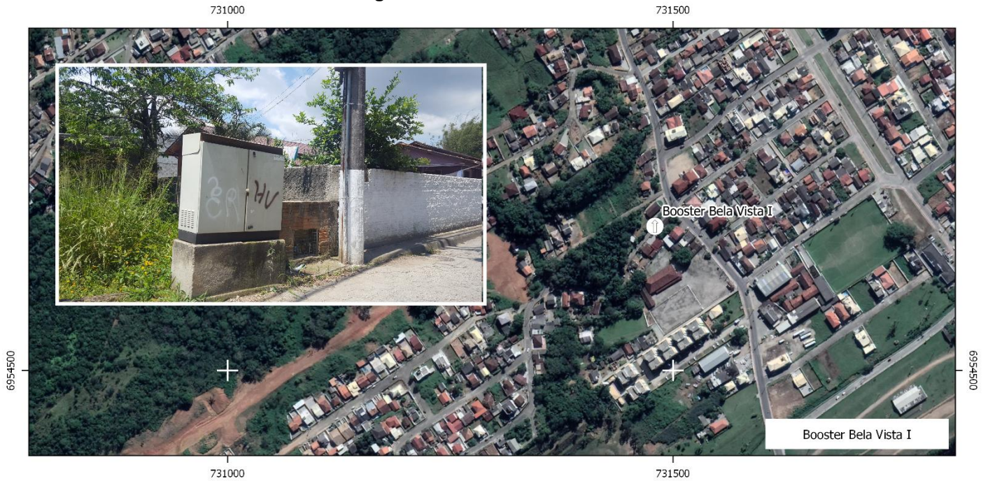
Figura 44: Booster Bela Vista I
