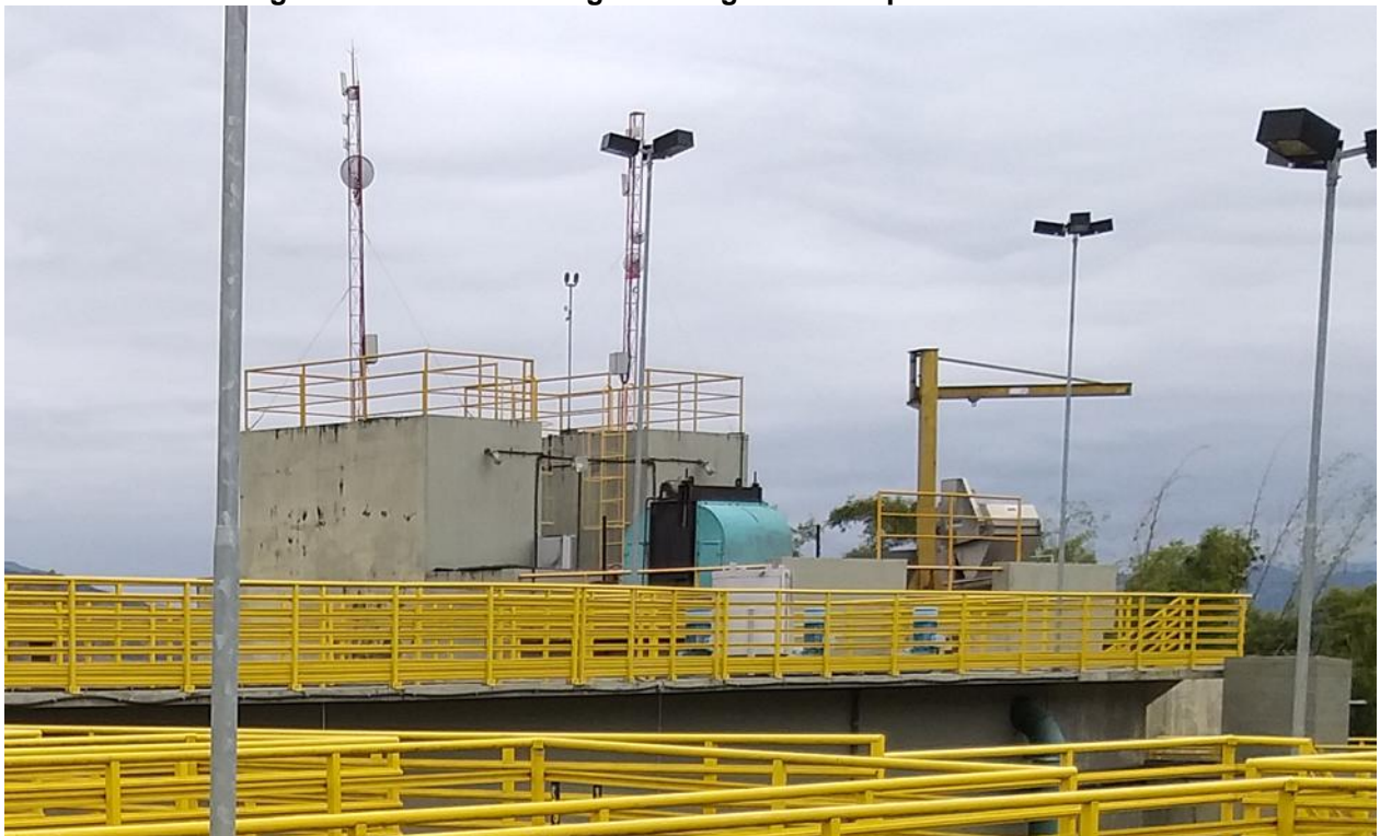
Figura 16: Caixas de chegada de água bruta e peneiras rotativas
