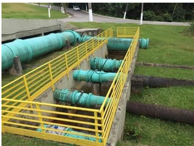
Figura 30: Adutoras de água tratada
