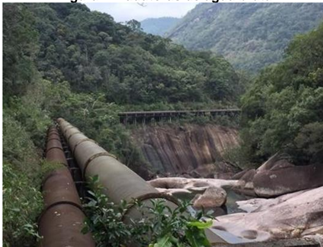
Figura 12: adutoras de água bruta
