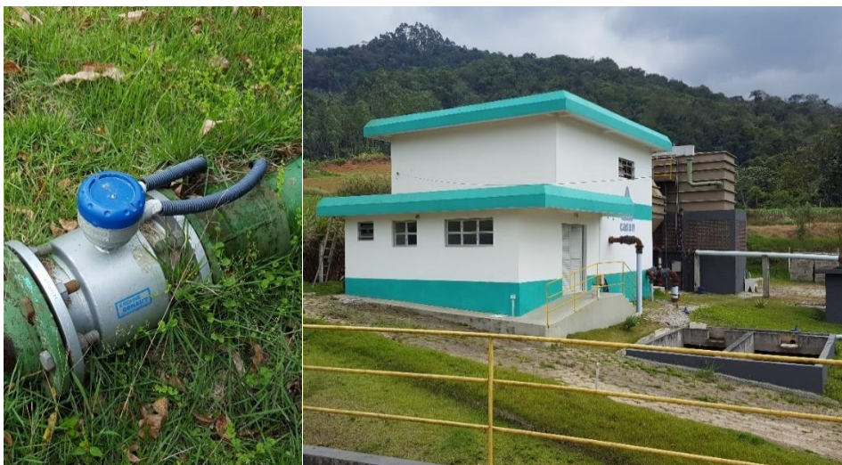
Figura 56: Macromedidor da Estação de Tratamento de Água de Antônio Carlos
