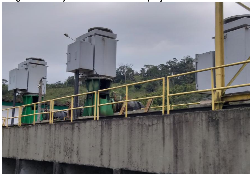
Figura 14: Conjunto motobombas - captação Rio Cubatão do Sul
